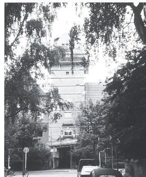
Wegen Steinschlags ist die Schultür zur Zeit überdacht
